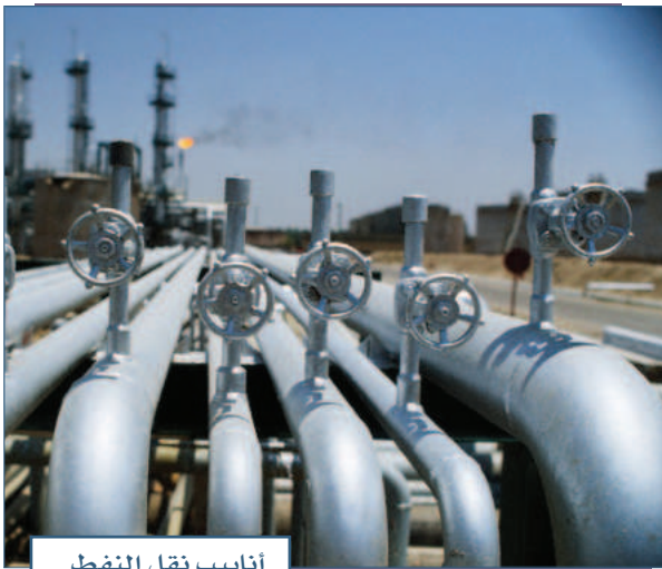
أنابيب نقل النفط
